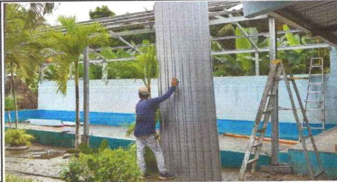
Foto1: Se inició con la Sustitución de lámina, por lámina troquelada aluzinc 12 calibre 26
