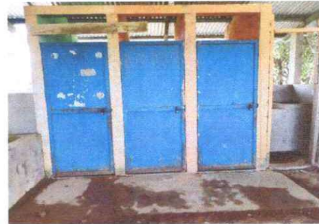
Foto 4: Mantenimiento a estructura (lijado, cambio de tubo , cepillado, sujeciones, aplicación de pintura) a puertas de servicio sanitario
