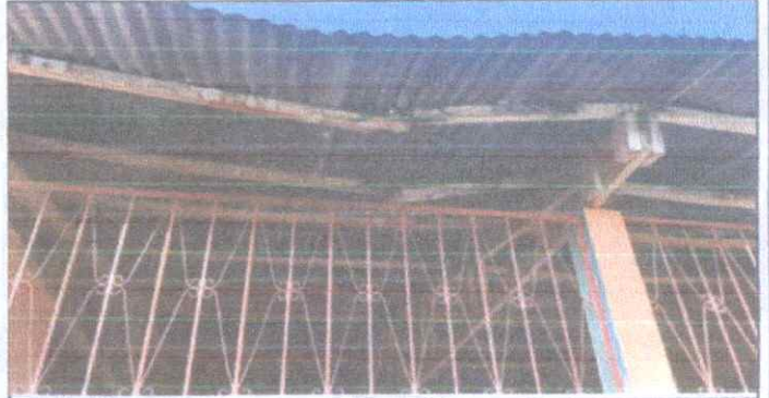
FOTO 2: ESTRUCTURA DE TECHO EN MAL ESTADO
