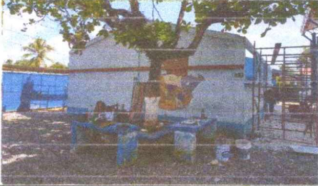
Foto 1. Un costado de las aulas que se están reparando
