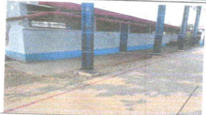
Foto 2. Parte de enfrente de las aulas que se necesita levantar el techo.
