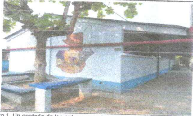
Foto 1. Un costado de las aulas que se levantará el techo, porque se inundan con agua de lluvia y posteriormente se levantará el piso
