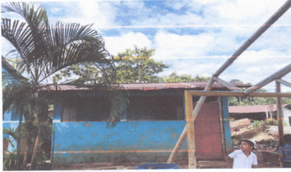
foto 1: lamina en mal estado
