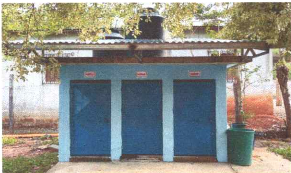
Foto 3: Reparación de servicios sanitarios, colocación de otro rotoplas, reparación de puertas, estructura metálica y techo de lámina.
