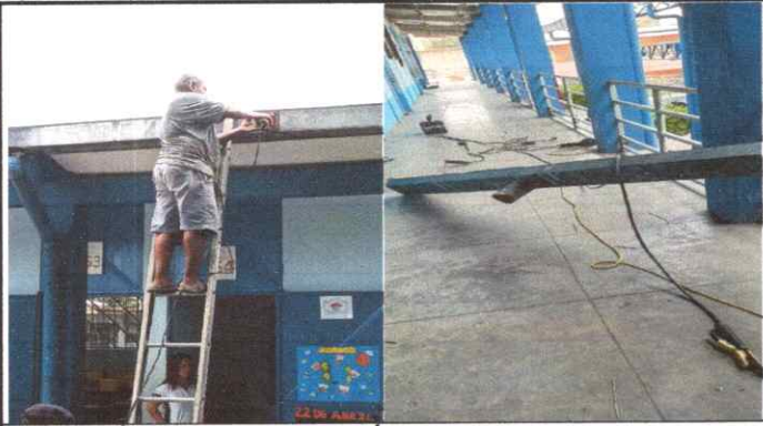
ELIMINACIÓN DE CANALES CORROÍDOS.
