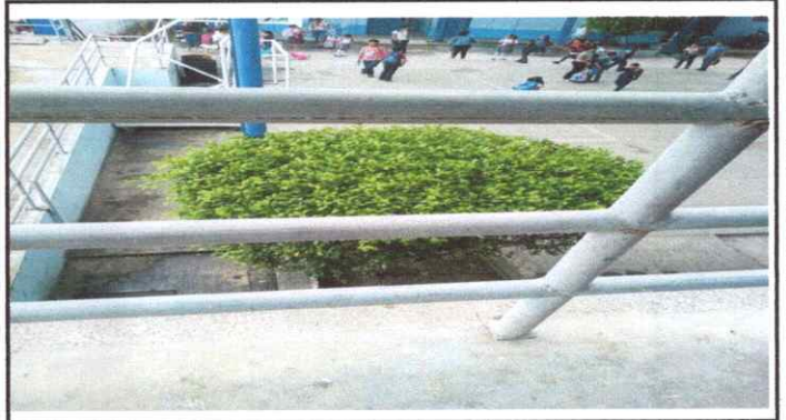
BARANDAL A REFORZAR.
