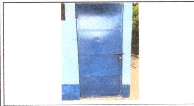
Foto 5: Sustrucción de puerta de aula
