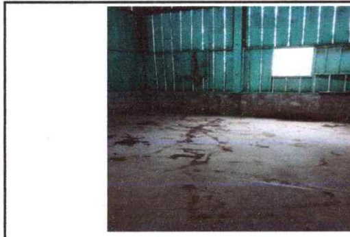
Foto 4: piso de aulas
