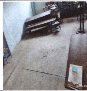
Foto 2: piso de aulas
