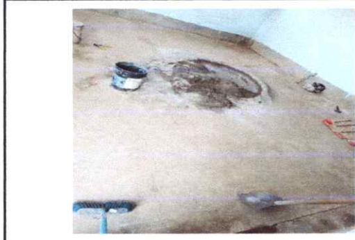
Foto 2: piso de aulas
