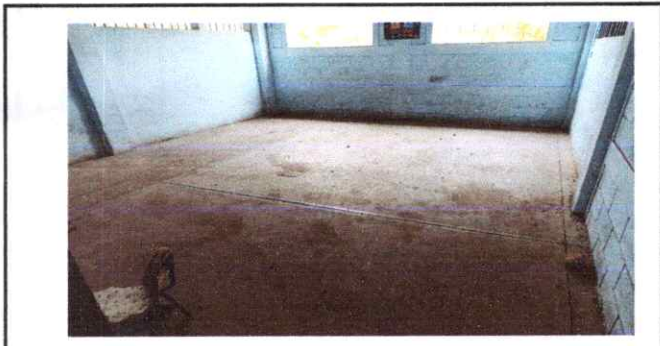
Foto 3: piso de aulas
