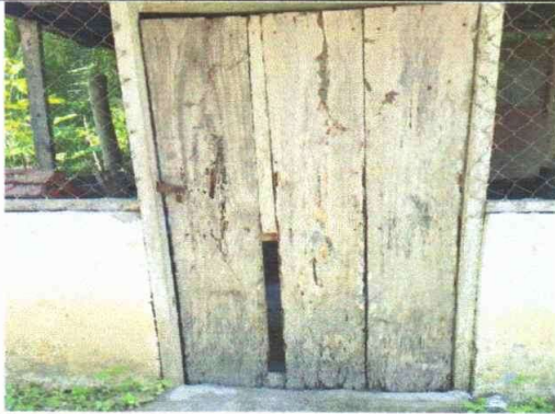
Sustitución de puerta en cocina, que se encuentra en malas condiciones
