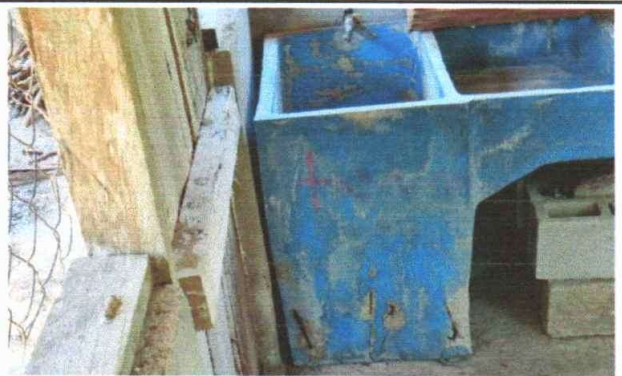
Pila con grietas.
