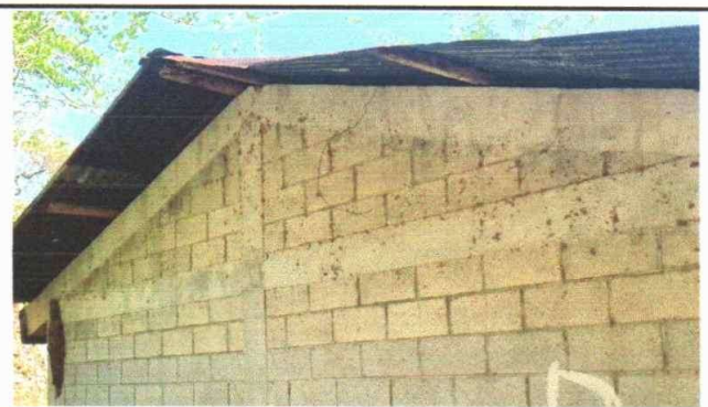
Lamina deteriorada y en malas condiciones.
