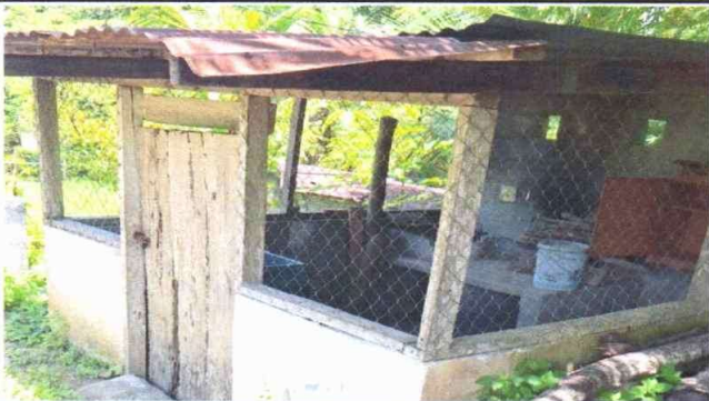
Condiciones en las que se encuentra la cocina del establecimiento.
