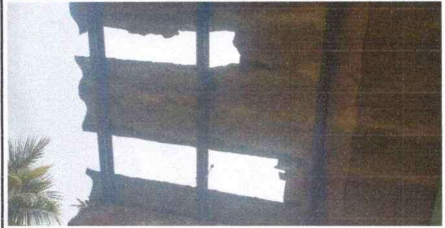
Foto 2: Sustrucción de lamina del corredor, debido a grandes perforaciones y que se encuentra en mal estado
