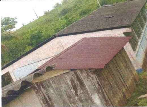
Foto 1: Sustrucción de lámina
