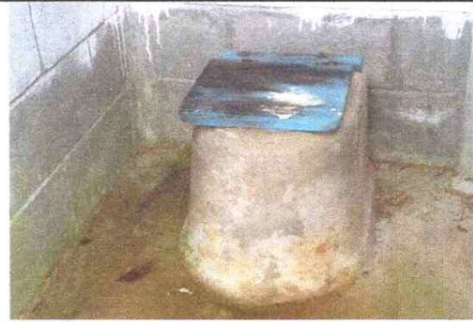
Foto 6: Baños en malas condiciones.
