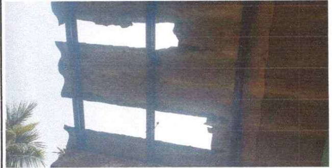
Foto 2: Sustrucción de lamina del corredor, debido a grandes perforaciones y que se encuentra en mal estado
