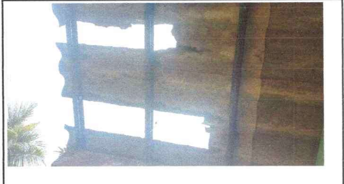
Foto 2: Sustrucción de lamina del corredor, debido a grandes perforaciones y que se encuentra en mal estado
