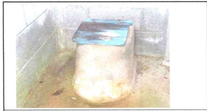
Foto 6: Baños en malas condiciones.
