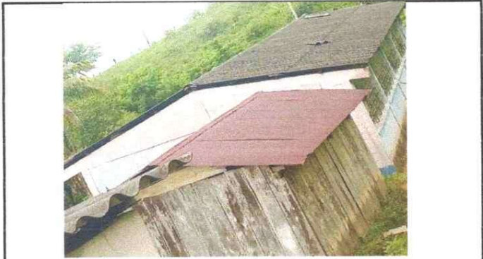
Foto 1: Sustrucción de lámina
