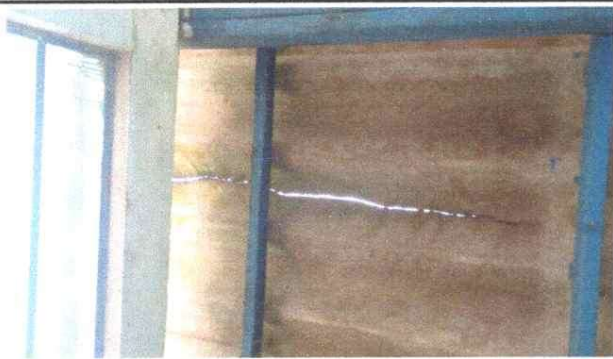
Foto 3: Sustrucción de lámina en mal estado
