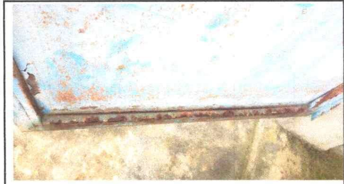
Foto 4: Mantenimiento de puertas, debido a que están dañadas.
