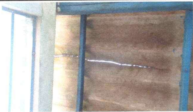
Foto 3: Sustrucción de lámina en mal estado
