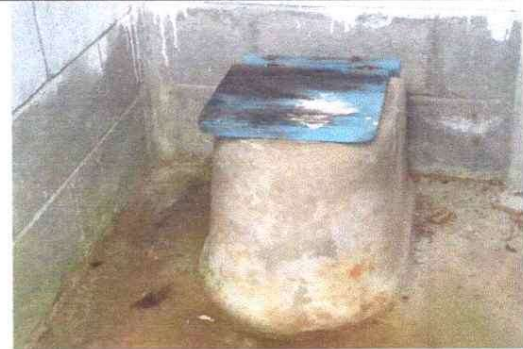
Foto 6: Baños en malas condiciones.
