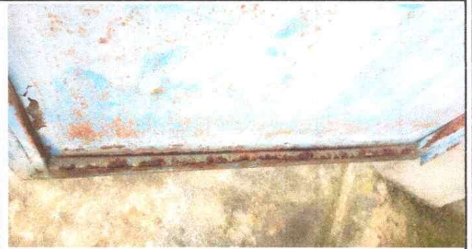
Foto 4: Mantenimiento de puertas, debido a que están dañadas.
