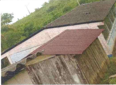
Foto 1: Sustrucción de lámina
