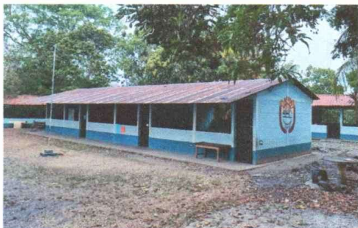
Foto 1: Sustitución de lámina, por lámina troquelada aluzinc calibre 26 y sustitución de capote de lámina para lámina troquelada.
