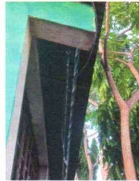
Foto 4: Sustitución de soporte o pescante de metal para canal
