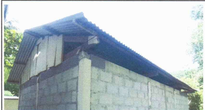
SUSTITUCIÓN DE LÁMINA POR LÁMINA TROQUELADA ALUZINC CALIBRE 26 Y ESTRUCTURA DE MADERA POR METAL DE BODEGA.
