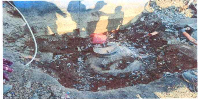
FOTO 2: POZOS DE SERVICIOS SANITARIOS EN MAL ESTADO.
