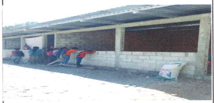
FOTO 6: FALTA PISO DE TORTA EN EL CORREDOR DE DOS AULAS.
