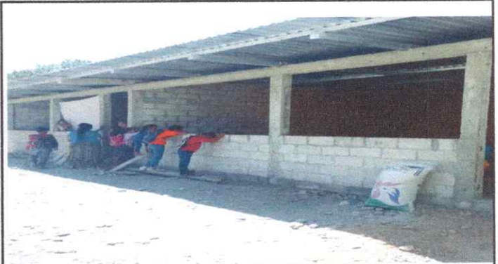
FOTO 4: FALTA DE BALCONES DE DOS AULAS.
