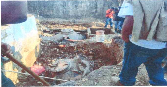
FOTO 1 : POZOS DE SERVICIOS SANITARIOS EN MAL ESTADO
