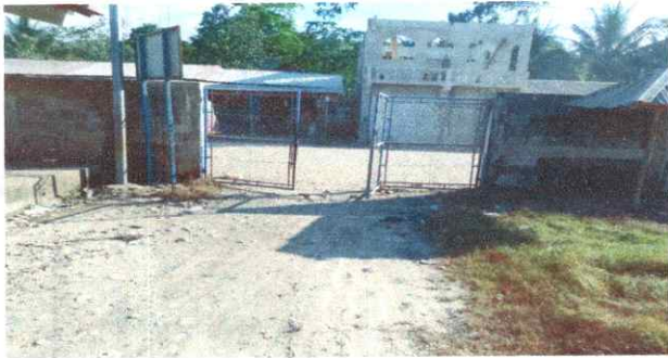
FOTO 3: PORTON EN MAL ESTADO.
