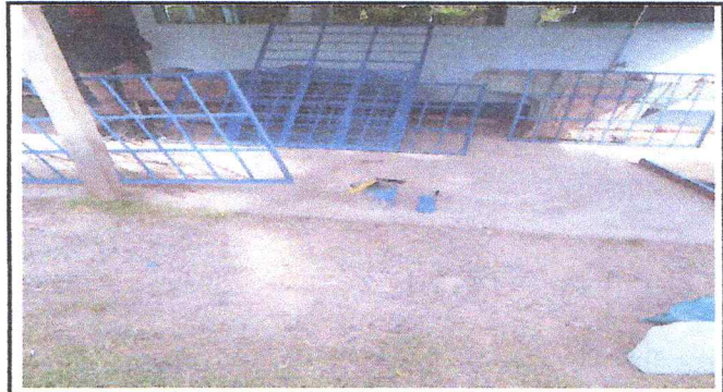
Foto 4: sustitucion de ventanas de madera por metal mas vidrio / sustituciones de balcones de metal.
