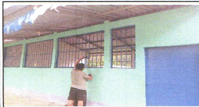
Foto 5: mantenimientos de de balcones de metal
