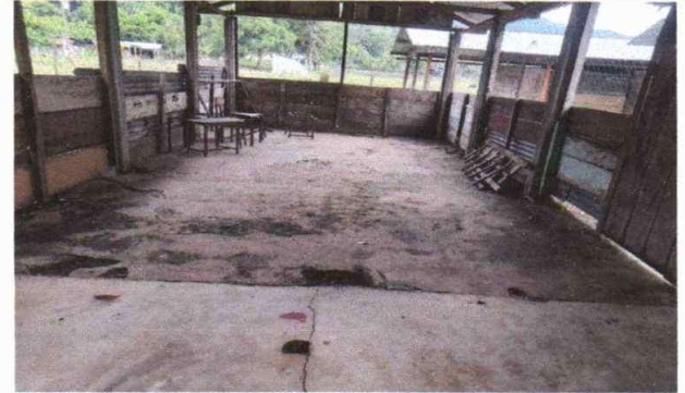
Foto 4: Sustrucción de piso de torta de concreto.
