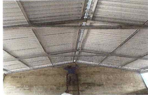
FOTO 2: ESTRUCTURA DE SOPORTE DE METAL EN AULA ADJUNTA A EORM CON LAS MEDIDAS DE 64 M2
