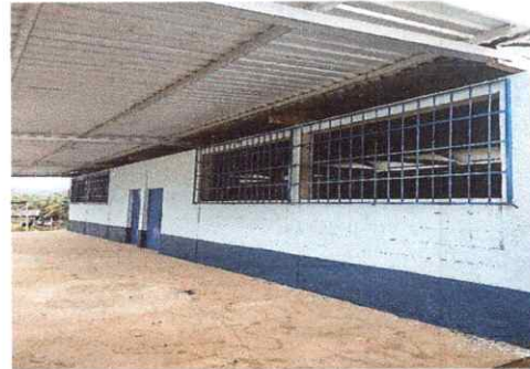
FOTO 4: SUSTICIÓN DE VENTANAS POR BALCONES EN COPB ANEXO A EORM
