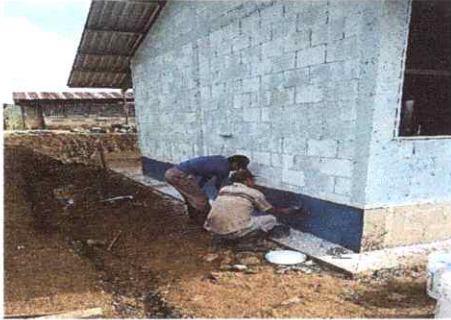
FOTO 7: PINTURA EN MUROS EXTERIORES DE LA EORM Y COPB ANEXO A EORM
