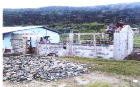
FOTO 2: LEVANTADO DE MURO DE AULA ADJUNTA A EORM CON LAS MEDIDAS DE 64 M2
