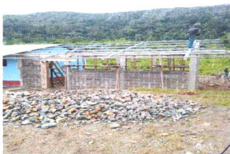
FOTO 3: COLOCACION DE ESTRUCTURA DE AULA ADJUNTA A EORM CON LAS MEDIDAS DE 64 M2
