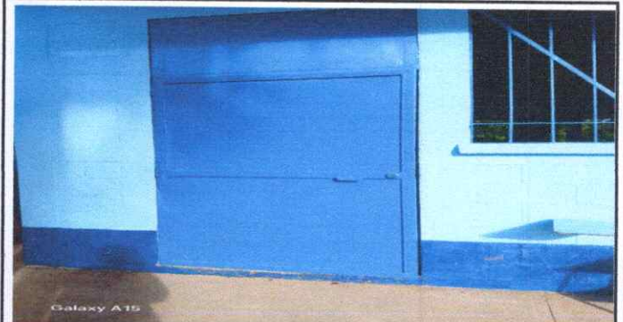
Foto 2: Puertas de Metal.
