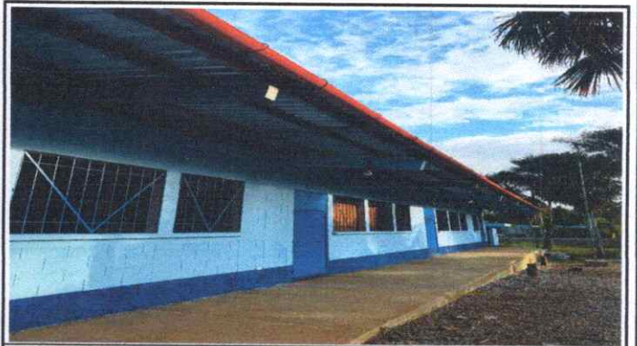
Foto 4: CANALES Y BAJADAS DE AGUA FLUVIAL.
