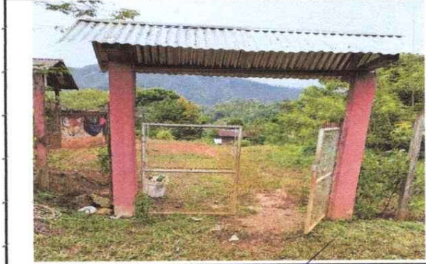
FOTO 2: Sustrucción de porton de metal.
