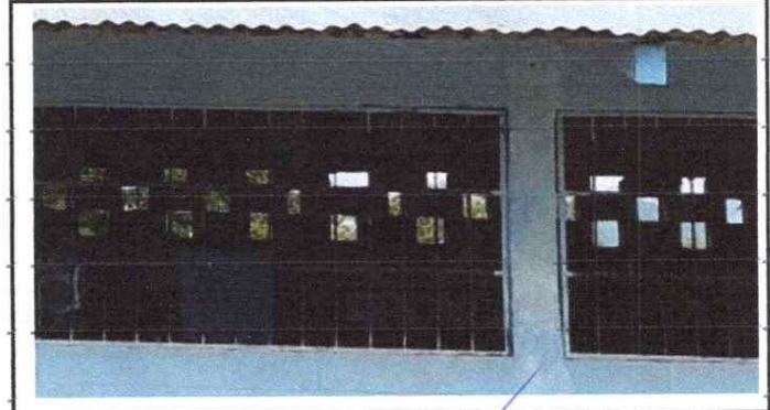
FOTO 4: Sustrucción de balcón de metal.
