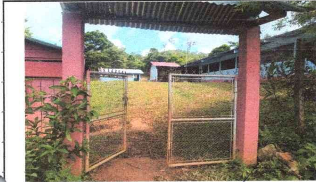
FOTO 1: Sustrucción de porton de metal.
