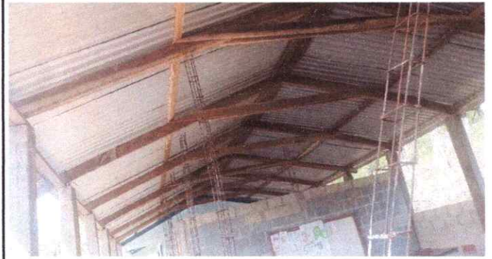
FOTO 2: ESTRUCTURA DE MADERA EN MAL ESTADO.
