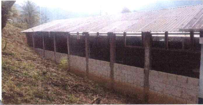
FOTO: LAMINAS ACANALADAS EN MAL ESTADO.
