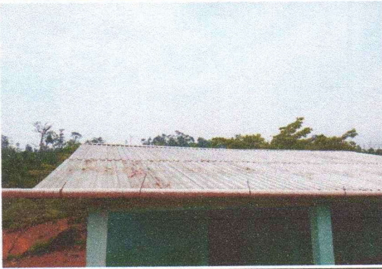
FOTO 1: Se observan las láminas que se necesitan sustituir
