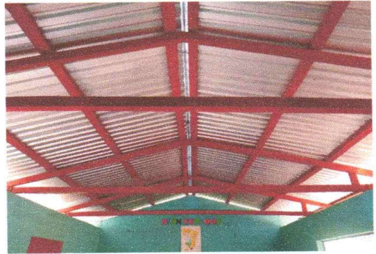
FOTO 2: Se observan las estructuras de techo de madera que necesita sustitución por estructura de metal
