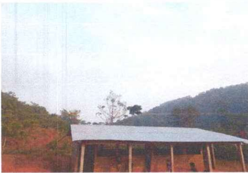
FOTO 3: Se observan láminas acanaladas que necesitan sustitución
