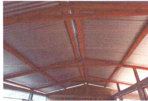
FOTO 4: Se observan estructura de soporte de madera, es necesario sustituirlas
