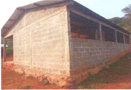
FOTO 1: Se puede observar paredes que necesitan repello
