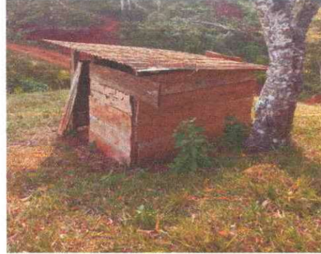
FOTO 2: Se puede observar el pésimo estado del servicio sanitario, es obligatorio su reparación o sustitución
