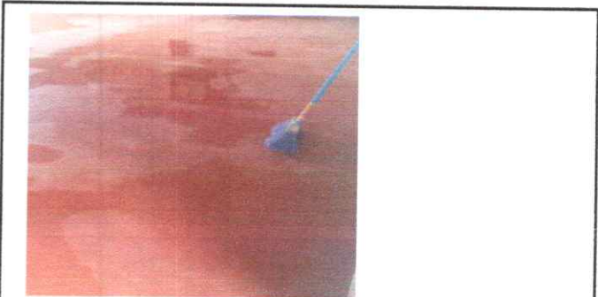
FOTO 3: Sustrucción de Piso de Torta de Concreto.
