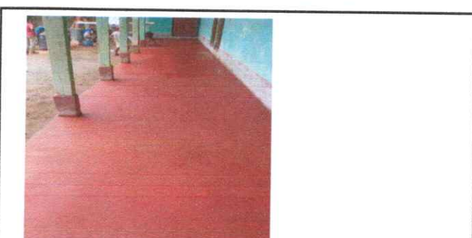
FOTO 4: Sustrucción de Piso de torta de concreto.
