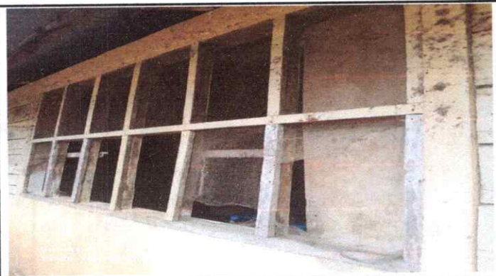
FOTO 3. MODULO 4. EN LA IMAGEN SE VE PUEDE OBSERVAR EL DETERIORO DE LA VENTANA DE MADERA Y SEDASO POR TAL RAZÓN SE NECESITA CONTRUIRLA DE METAL.
