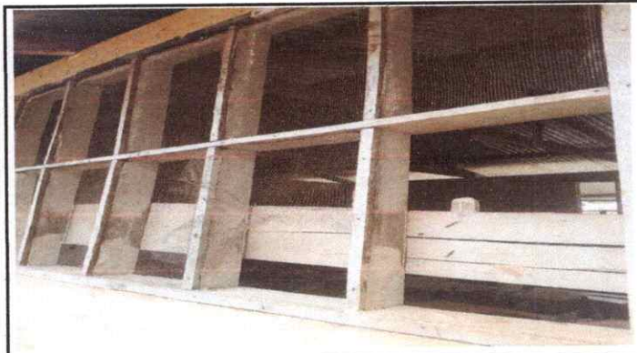
FOTO 4. MODULO 4. EN LA IMAGEN SE PUEDE APRECIAR LA VENTANA 4 DE LA PARTE DE ATRÁS DEL AULA. TAMBIÉN NECESITA REPARACIÓN DE LA MADERA Y SEDASO.
