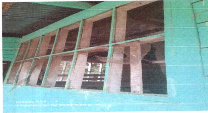
FOTO 1. MODULO 4. EN LA IMAGEN SE PUEDE APRECIAR LA VENTANA FRONTAL DEL AULA SE ENCUENTRA DETERIORADA Y NECESITA REPARACIÓN.
