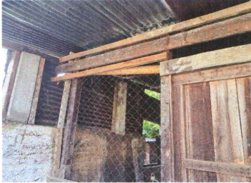
Foto 1: Sustrucción de puerta
