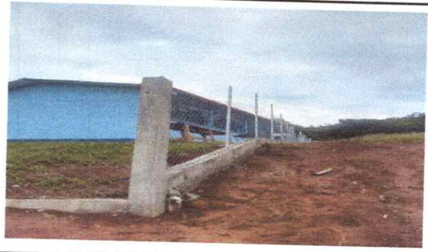
FOTO 3. SE CONSTATA LA CULMINACION BASADO EN SUSTITUCION DE COLUMNAS Y INSTALACION DE MALLA
