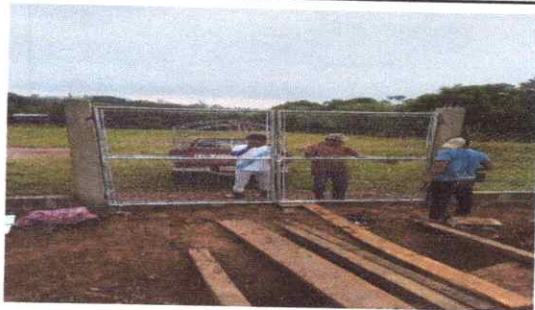
FOTO 1: SE ONSERVA LA SUSTITUCIÓN DE PORTON.
