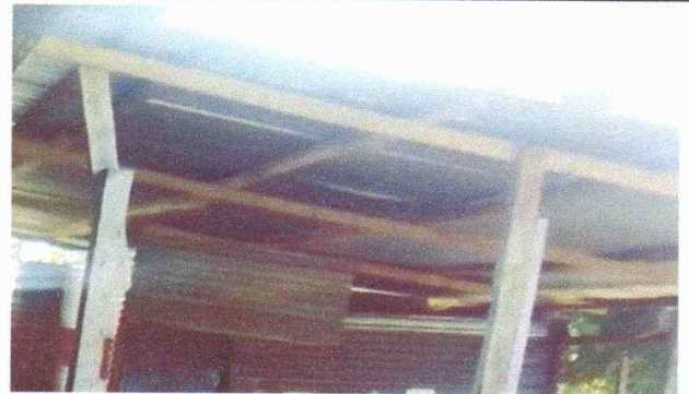
Foto 2: SUSTICION DE ESTRUCTURA DE SOPORTE DE MADERA POR METAL
