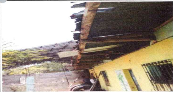
DETERIORO DEL TECHADO
