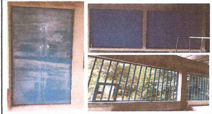
FOTO 2: Fabricación e Instalación de Puertas de metal en cocina y Fabricación e instalación de ventana-balcon de metal
