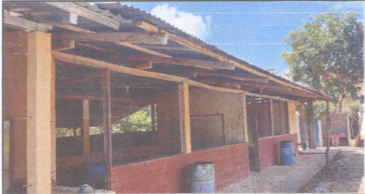
Foto 1: Sustitución de láminas, por láminas troqueladas. Sustitución de estructura de madera, por metal. Fabricación e instalación de balcones de metal (aula de primero, cocina y sanitarios)
