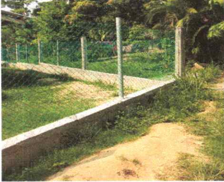
Foto 1. Muro perimetral de block con tubo hg y malla galvanizada, soleras intermedias y columnas finalizado en su totalidad.
