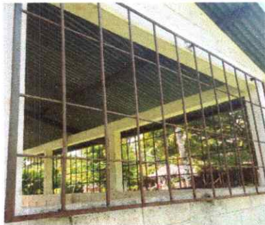
foto 5. Balcones en mal estado y oxidadas.
