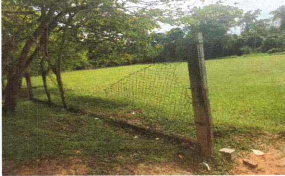
Foto 1. Malla muy deteriorada
