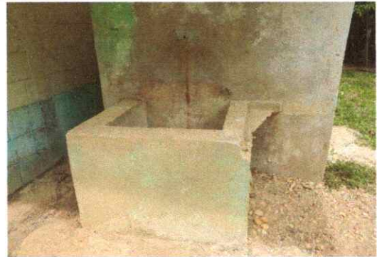
foto 4. Lavadero en mal estado por deterioro.
