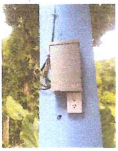
FOTO 3: Instalación de tablero eléctrico y flípones de unidades de luz, instalación de acometida, instalación de unidades de fuerza.
