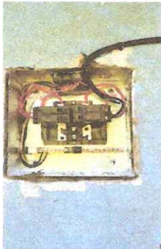
FOTO 3: Instalación de tablero eléctrico y filpones de unidades de luz, instalación de acometida, instalación de unidades de fuerza.
