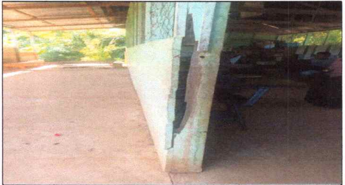
Foto 2: Deterioro de la entrada al aula.
