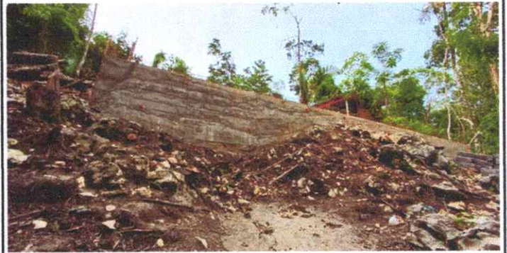
ESTA ES LA VISTA DE LA CONSTRUCCION DEL MURO DE CONTENCION QUE REFUERZA LA BODEGA
