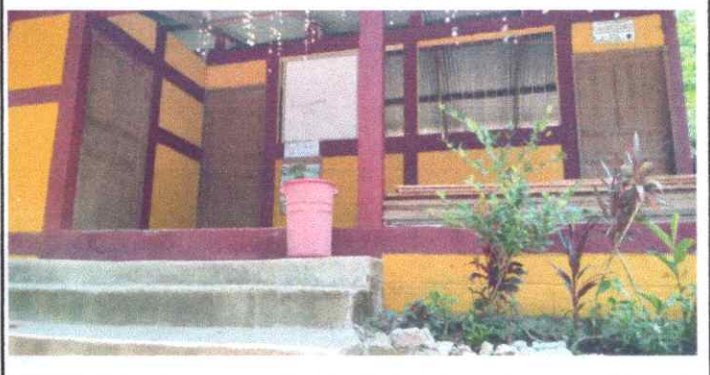
OBSERVAMOS LAS PUERTAS PERO SUS MARCOS ESTAN DESPRENDIDAS
