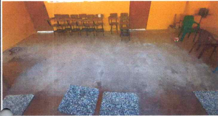
SE OBSERVA UNA TORTA DE CEMENTO EN MUY MAL ESTADO
