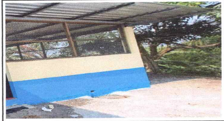
FOTO 4: Sustitución de estructura de metal de ventana, se cambio el metal por madera tratada
