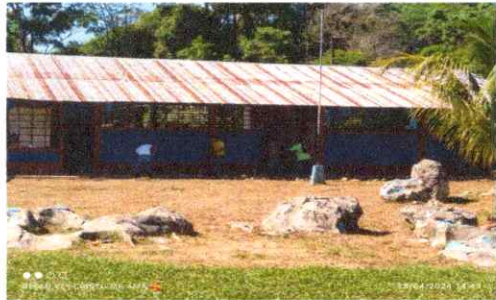
FOTO 2. Lamina en mal estado. 18/4/24
