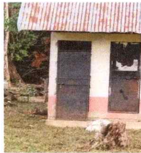
Foto 4: puerta de sanitario desprendida de su base por el deterioro. 18/4/24
