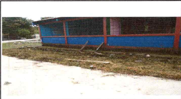
FOTO 1. Banqueta en mal estado. 30/3/24
