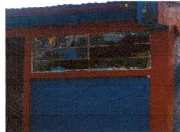
foto 6: ventana en mal estado. 18/4/24
