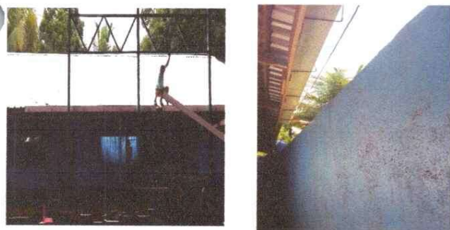
Foto 5: Ejecución de la reparación de bajada de agua de metal por PVC.
