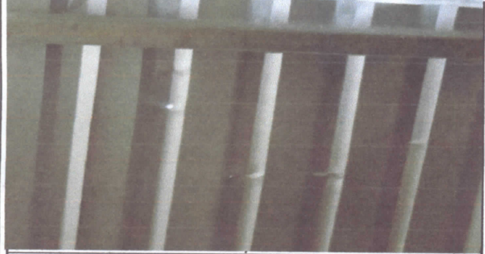
sustitución de lámina, por lamina troquelada aluzinc calibre 26 EODP anexa a EORM
