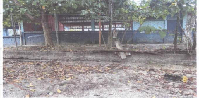
Reparación de muro perimetral de block con tubo hg y malla galvanizada, soleras intermedias y columnas.
