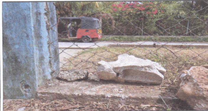
Muro perimetral dañado por la interperie.
