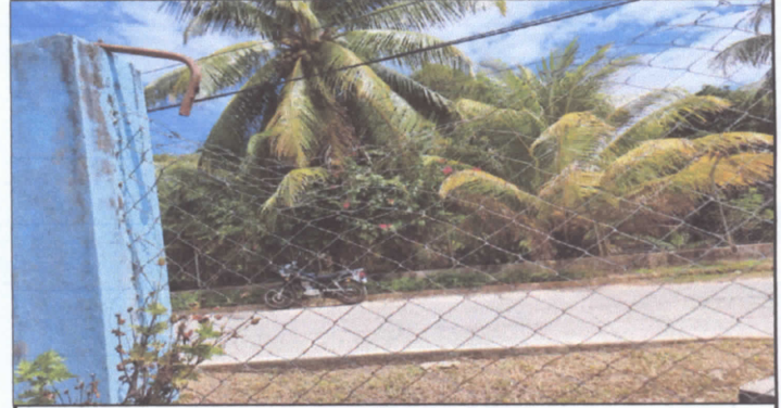
Tubos y mallas del muro perimetral muy dañadas.
