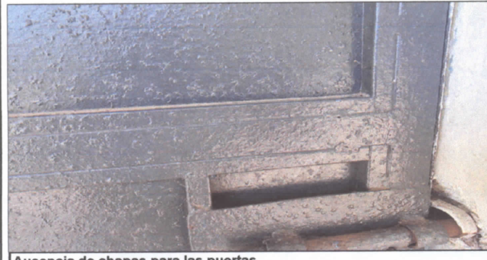
Ausencia de chapas para las puertas.
