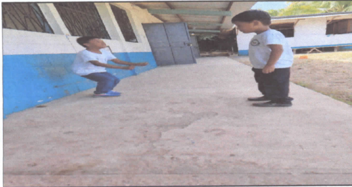
Piso del corredor en mal estado.
