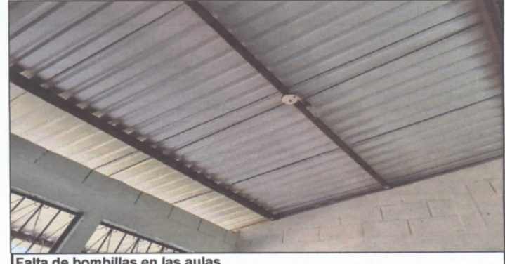
Falta de bombillas en las aulas.
