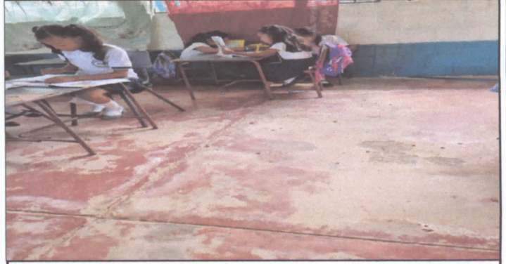
Piso de las aulas muy deterioradas.
