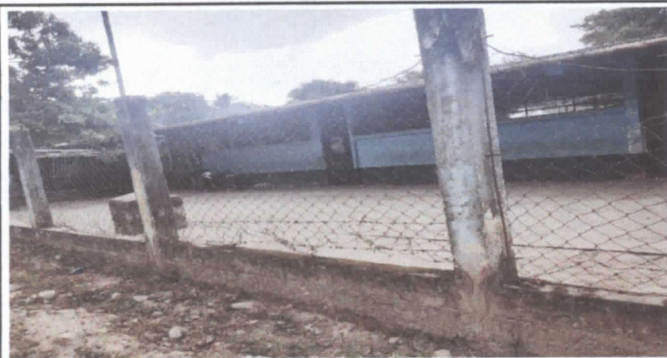
Reparación de muro perimetral de block con tubo hg y malla galvanizada
