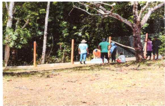
Foto 4: Reparación del cerco de la escuela con malla galvanizada y tubo hg.
