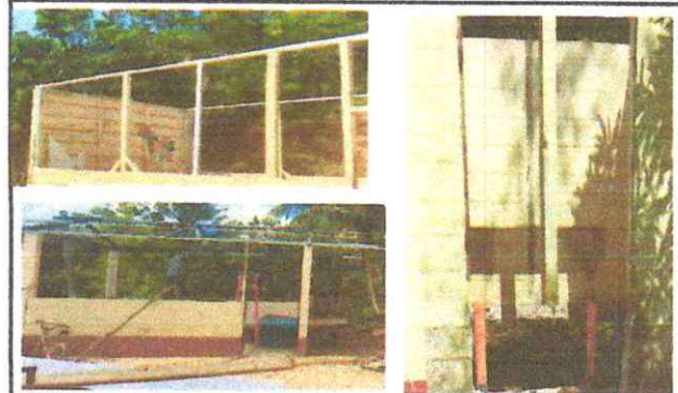
Fotos 2: Sustitucion de estructura de soporte de madera, por metal en Aula, cocina y Baño
